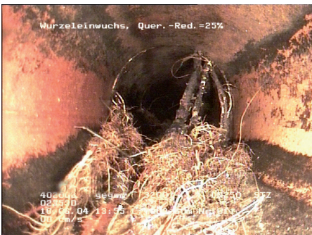
Abb. 1a: Beispiel für Schadensbild: Wurzeleinwuchs
